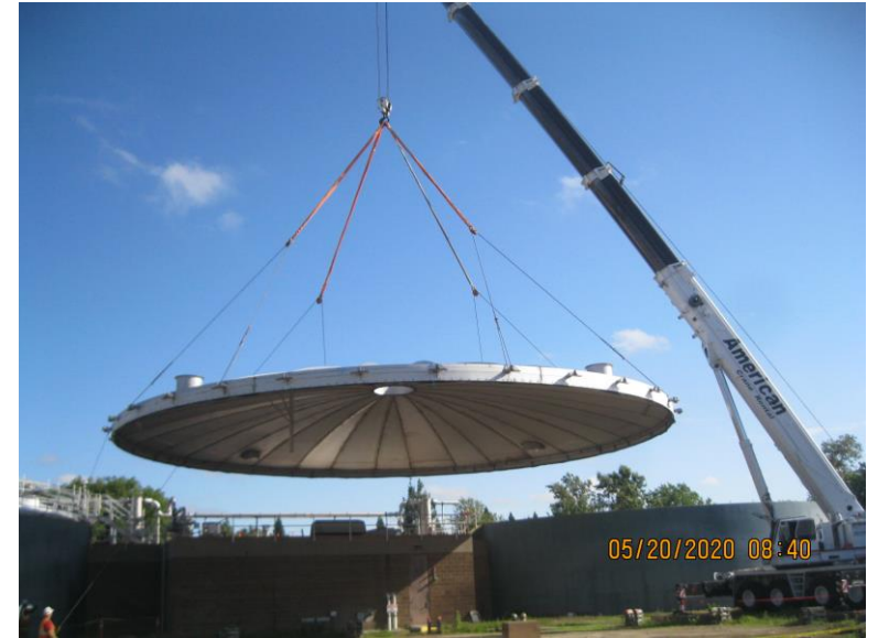
New Digester Lid
